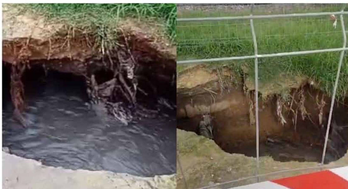
Socavones en la barriada San Enrique de Jerez.
